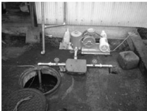
写真 2. 設置したブロー、地下が尿溜(2 槽ある)
