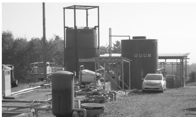
写真1 発電施設全景
