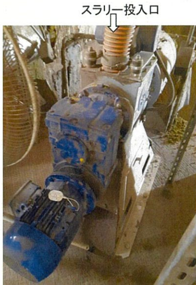
写真2 スラリー用の固液分離機(本体前部)
