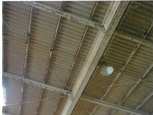
写真 13 屋根鉄骨部分の腐食
