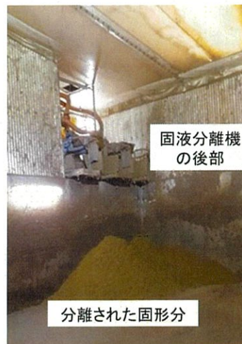
写真3 固液分離機で分離された固形分
