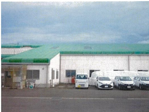
写真 12 屋根の破損(緑色のスレート)
