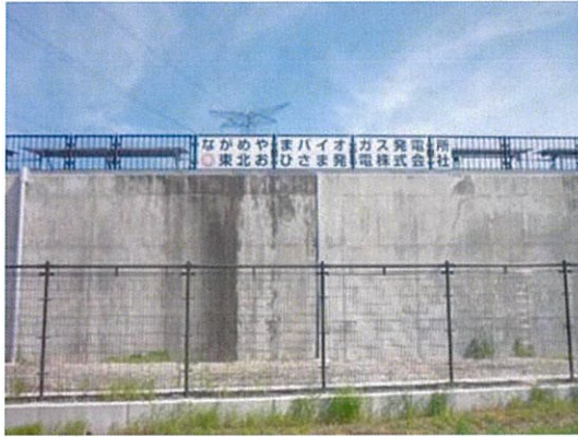
写真8 消化液貯留槽
