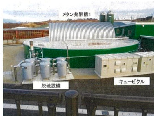
写真5 脱硫設備、キュービクル
