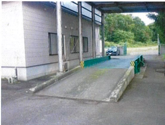
写真2 トラックスケールの計量装置
