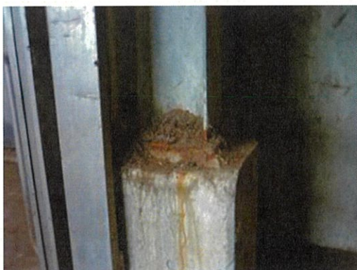
写真 14 建物支柱下部の腐食
