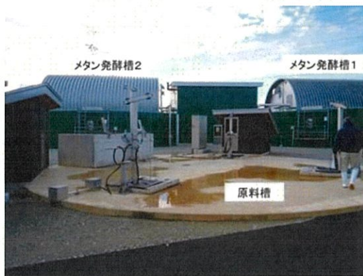
写真4 原料槽、メタン発酵槽1, 2
