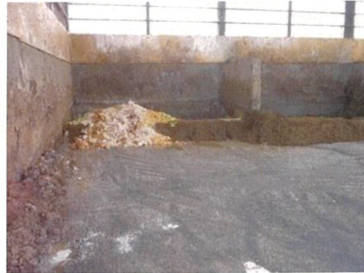
写真3 副原料棟に貯留された食品廃棄物
