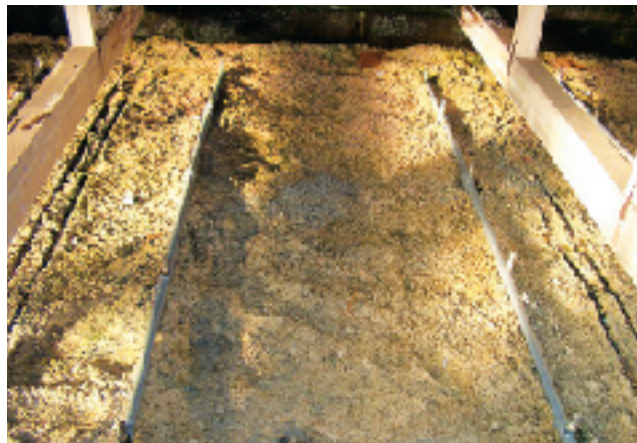
ロックウール脱臭装置内部
