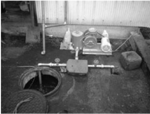
写真2. 設置したブロワー、地下が尿溜(2槽ある)
