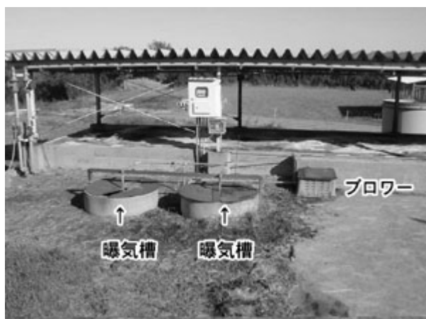
写真1. 畜産試験場の簡易曝気処理施設とオガクズろ床
