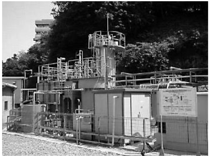
写真1 パイロットプラント
