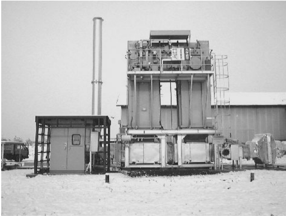
写真1 蓄熱式燃焼脱臭装置 全景写真
